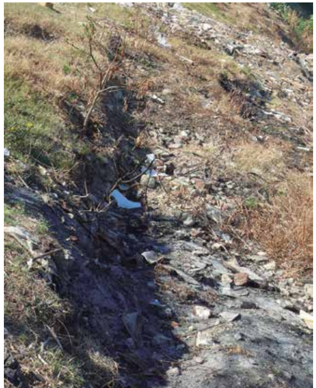
Figura 10. Vista en detalle de la formación del escarpe en el talud ubicado detrás del motel Bella Vista
