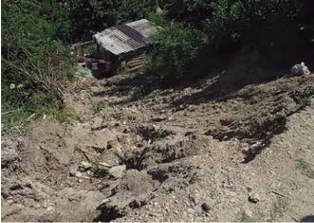
Figura 7. Deslizamiento ubicado entre calle 10 y 14, en el reparto Altamira, al este de la bahía de Santiago de Cuba
