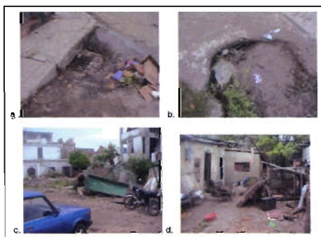
Figura 13. a. y b. Red de alcantarillas tupidas, c. Puesto de vianda destruido (Amenidad y Cruz del Padre, d. Patio destruido (San Martín).
