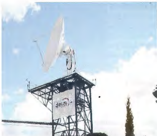
Figura 2.- Centro de Control de Boecillo
