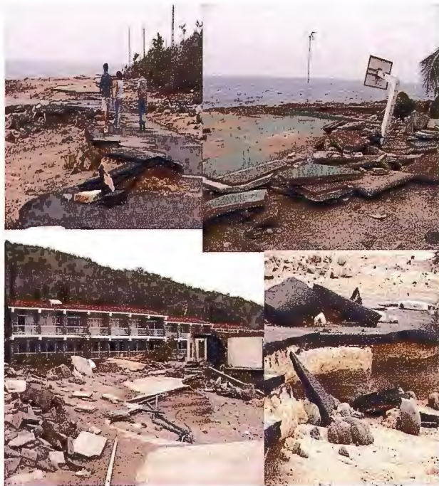
Fig. 1 Imágenes de las afectaciones provocadas por la acción del mar durante los huracanes en las instalaciones del Hotel Bucanero, situado al este de la ciudad de Santiago de Cuba, Parque Baconao, 2006.
