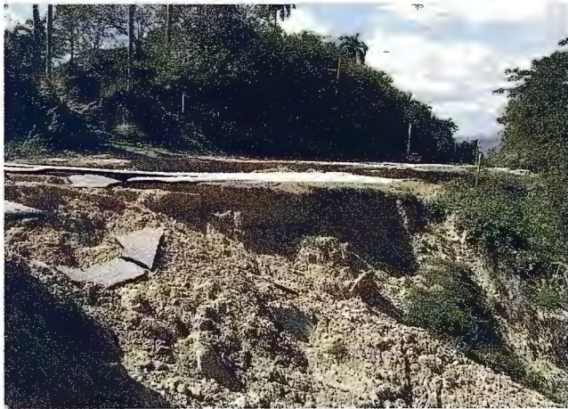
Foto 2. Destrucción de la carretera de la Güira a Boquerón por un deslizamiento. (Sector b)
