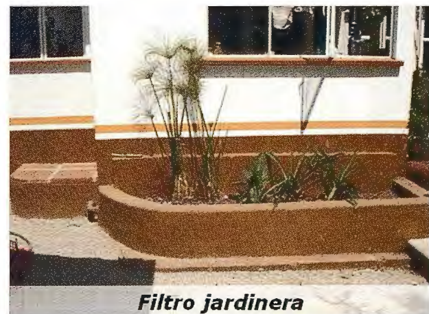
Foto 2. Sistema filtro jardinera en el cual están las salidas directas de los tubos de la casa muestra, a la jardinera/receptáculo, Filtro principal, cuyo esquema de funcionamiento se describe en el esquema expuesto a continuación.
