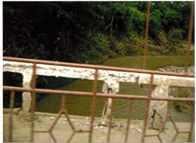
Foto 2. Destrucción de las barandas de hormigón hidráulico del Puente a la entrada del poblado de Mayarí por la crecida del río Mayarí.
