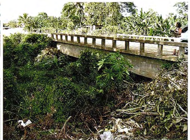
Foto 6. Vertimiento libre de residuales sólidos en las márgenes del río Mayarí, puente hacia el municipio de Sagua de Tánamo de la provincia de Holguín
