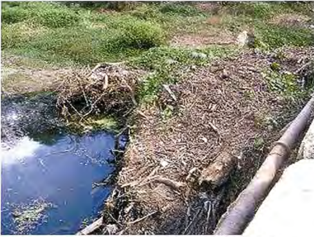
Foto 7: Acumulación de material de todo tipo, taponeando una alcantarilla
