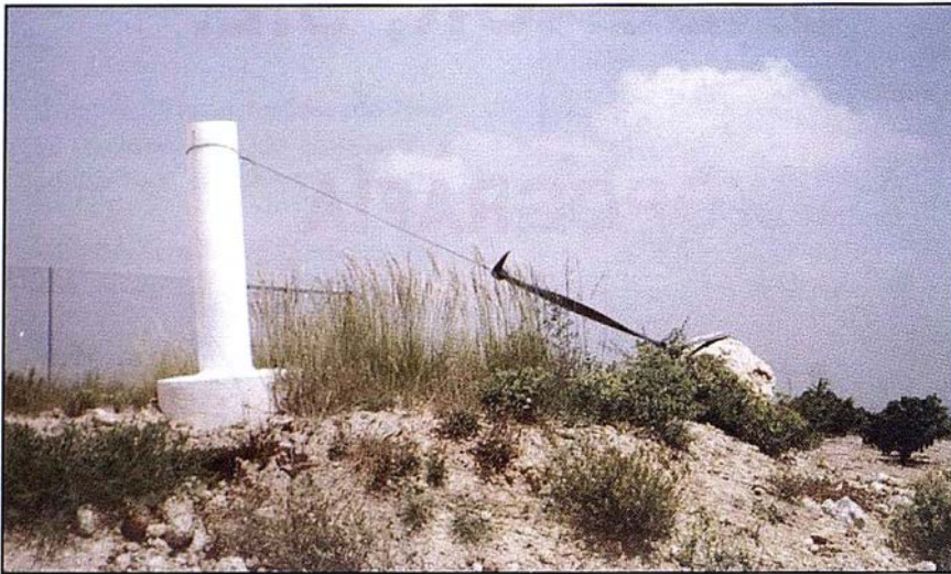
Figura 13. Vista tomada desde el otro lado, se aprecia claramente la inclinación del vértice y la excavación en la base.
