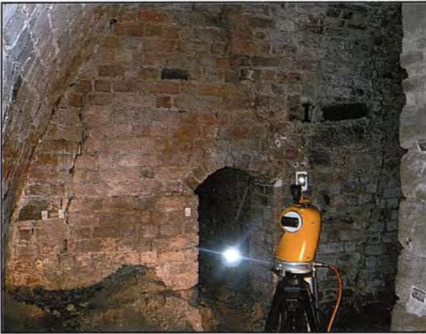
Imagen 8: Levantamiento en sótano con daños estructurales.
